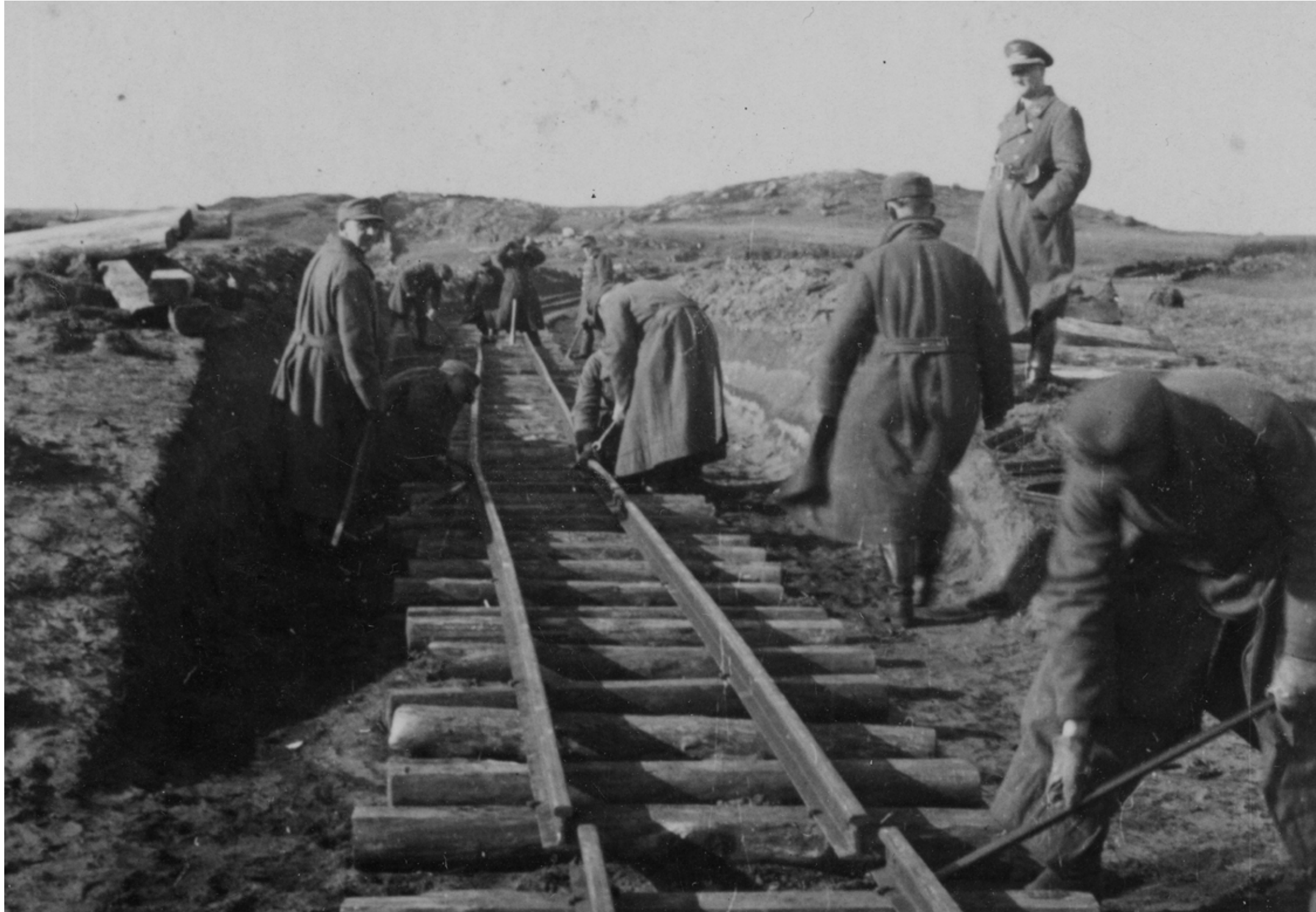
Fra byggingen av Lundebanen på Lista. Denne smalsporede jernbanen ble bygget for å transportere forsyninger og byggematerialer fra havna i Lundevågen til tyske byggeplasser på Lista. Foruten flyplassen var batteriene i Marka og på Tjørveneset de største anleggene. Jernbanen hadde flere sidespor, blant annet til sandvaskeriet på Nesheim og steinbruddet i Mabergåsen. Illustrasjonsfoto, som ikke er knyttet til personene som beskrives i historien. FOTO: LISTA MUSEUM
